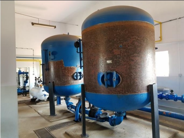
Zbiorniki hydroforowe, do demontażu przez inwestora
