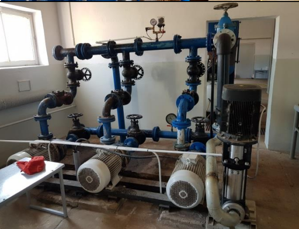
Pompownia II° z pompą CR20-6/7,5 kW, pompownia zostanie zdemontowana przez inwestora, pompę CR20-6/7,5 kW wykonawca zamontuje w nowym zestawie hydroforowym.
